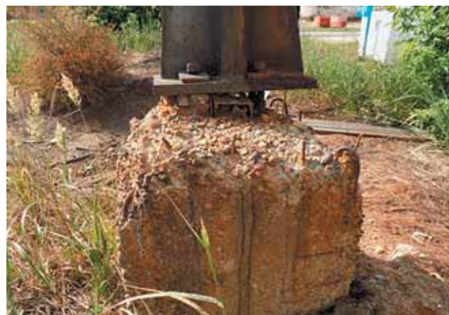
▲ Примеры разрушений и повреждений железобетонных конструкций трубопроводных эстакад в АО «АНХК» ▲ Examples of destruction and damage of the pipe racks reinforced concrete structures in AO ANKHK
